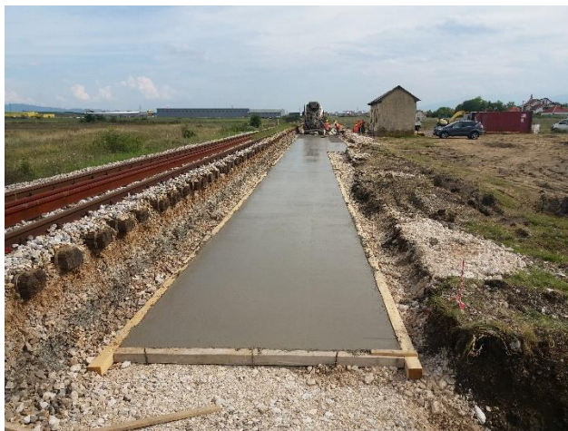
Punët e betonimit me beton te varfër
